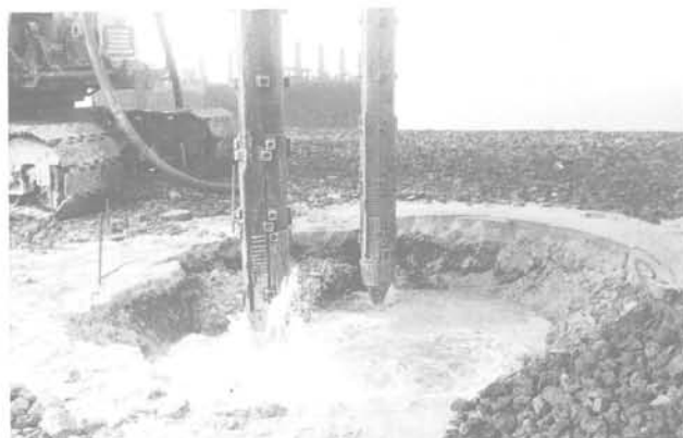
Fig. 11 Affaissement de la plate-forme en cours de fonçage
