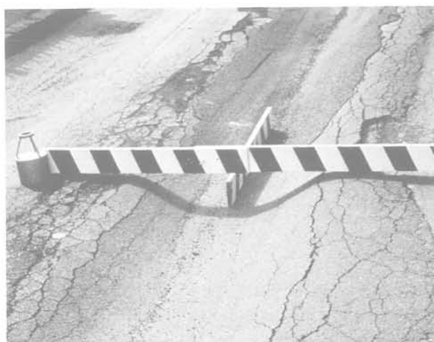
Fig. 1 Affaissement de chaussée
