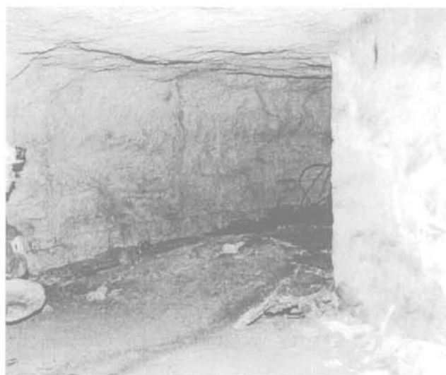
FIG. 4 Poinçonnement d'un pilier artificiel de galerie de sable au travers de la planche intermédiaire. Intermediate layer failure of a pillar in a gallery in sand.
