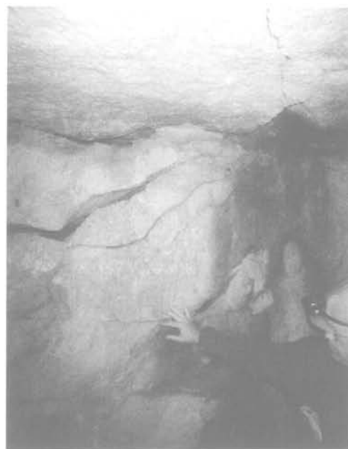
FIG. 3 Rupture en traction d'un pilier. Tensile failure of a pillar.
